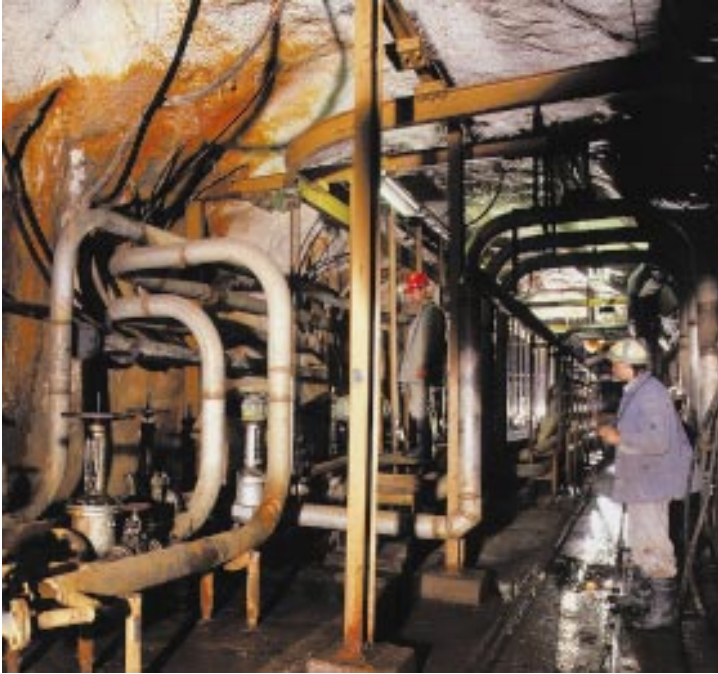
Abb. 2 Untertägige Pumpstation zur Urananlagerung im vererzten Sandstein Foto: Rainer Bode, Bode Verlag GmbH, Haltern
